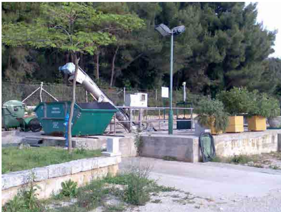
Slika 2.2. Automatsko fino sito uređaja u postojećem stanju
